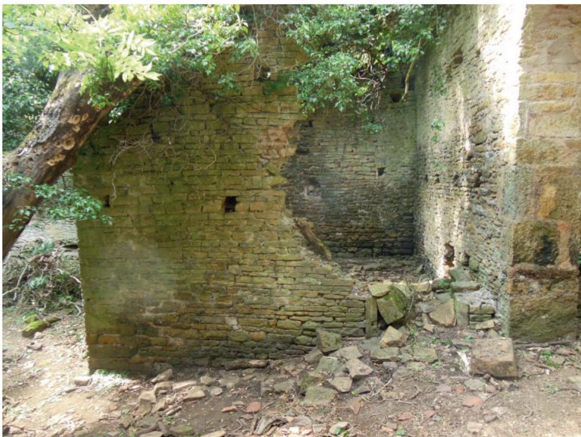
Fig. 13 : petite écurie, brèche de la porte juillet 2013.
