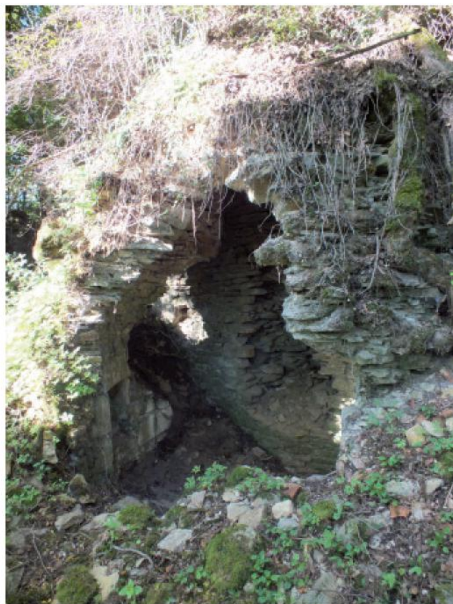
Fig. 4 : état avant travaux (août 2012). On aperçoit au fond de la tour la brèche qui affecte l'angle du mur de courtine.
