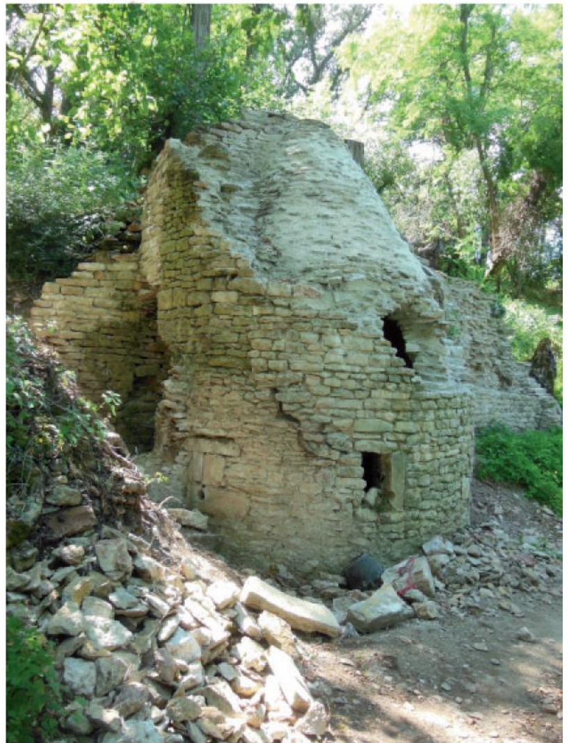
Fig. 8 : tourelle restaurée, vue de l'est. La canonnière de gauche est en place ; celle de droite a été partiellement remontée avec une pierre trouvée dans les déblais de démolition.
