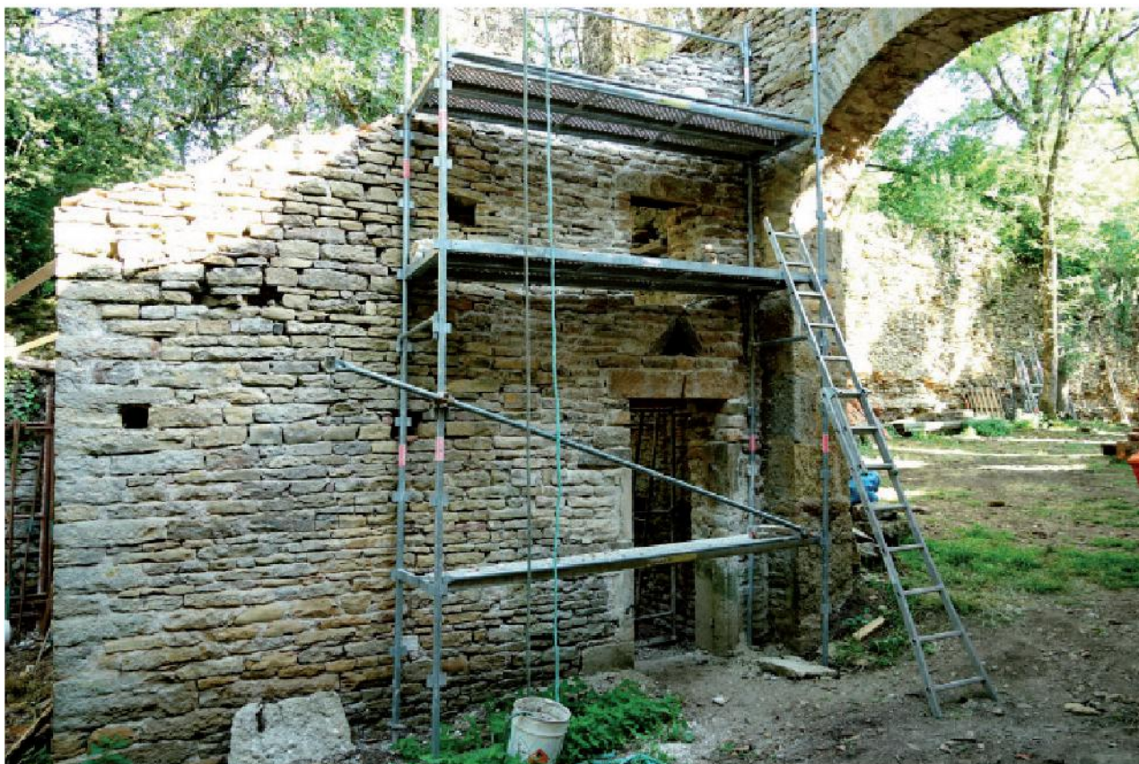
Fig. 16 : petite écurie, porte et fenêtre nord-est restaurées d'après la photo de 1940.
